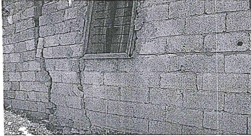
Resim 2- Duvarlarında çatlak ve yarıklar oluşan, temeli ayrılmış konutlardan örnek.
