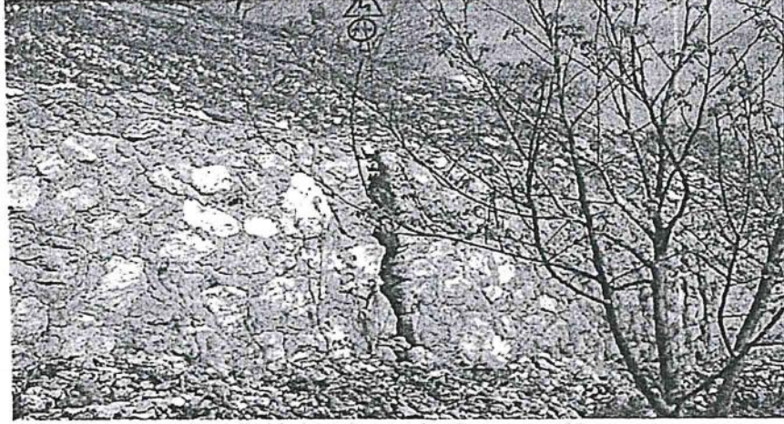
Resim 1- Yolun altındaki istinat duvarında oluşmuş yarıklar.
